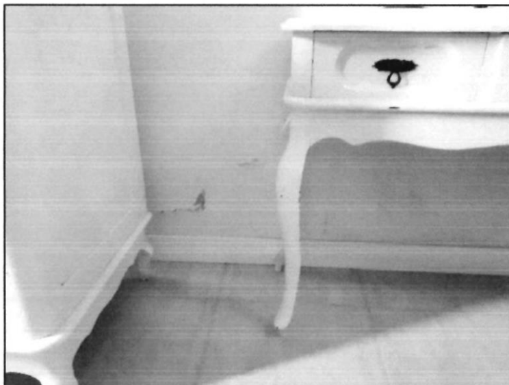
Figura 28 - região de infiltração quarto 1, torneira externa que foi consertada.
