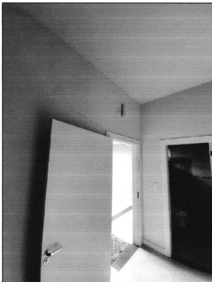
Figura 16 - porta fundos, com fissura.
